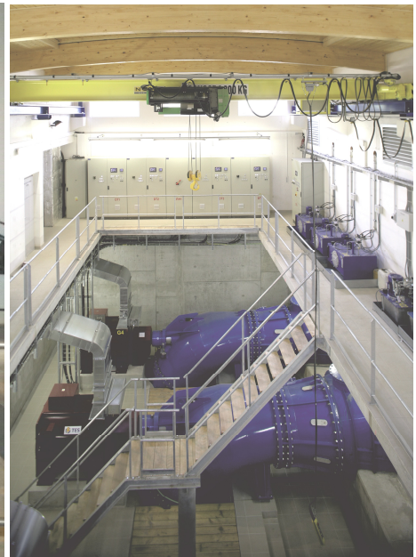
.. strojovna nové MVE na opraveném VD..
